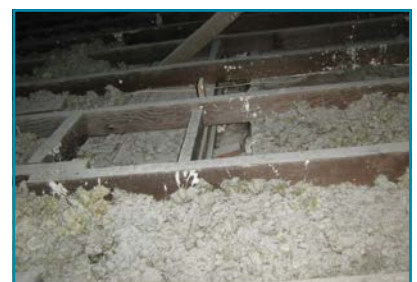
A. Friable Asbestos Example
